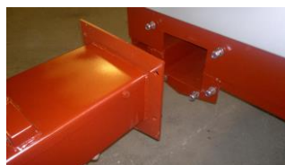
Skruvrännan är bultad mot förrådet.
